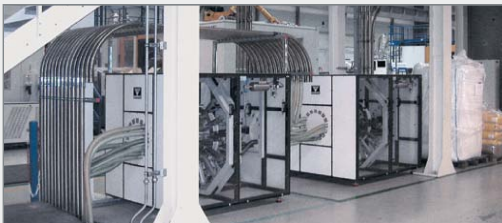
Zwei Navigatoren installiert für die Fertigung von Karosserieteilen eines international bekannten Automobilherstellers
