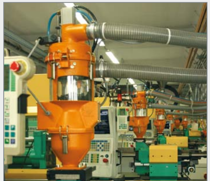
A 2 mit Zwischentrichter Z 1 in einer Zentralförderanlage
