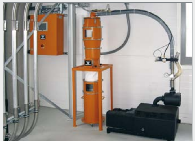
Sa 3 Sicherheitsfilter mit SPS Steuerung (links) und Vakuumpumpe
