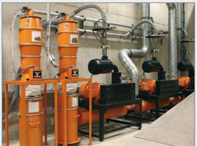
Vakuumpumpen mit 11 kW und Sa 3 Sicherheitsfilter mit 60l Auffangbehälter
