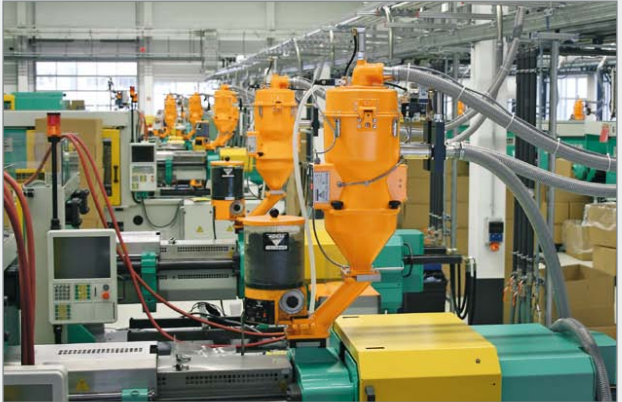
Zentralförderanlage mit Direkteinfärbung über KEM / AZ / Z5 + Tm A 8 Förderabscheider.
