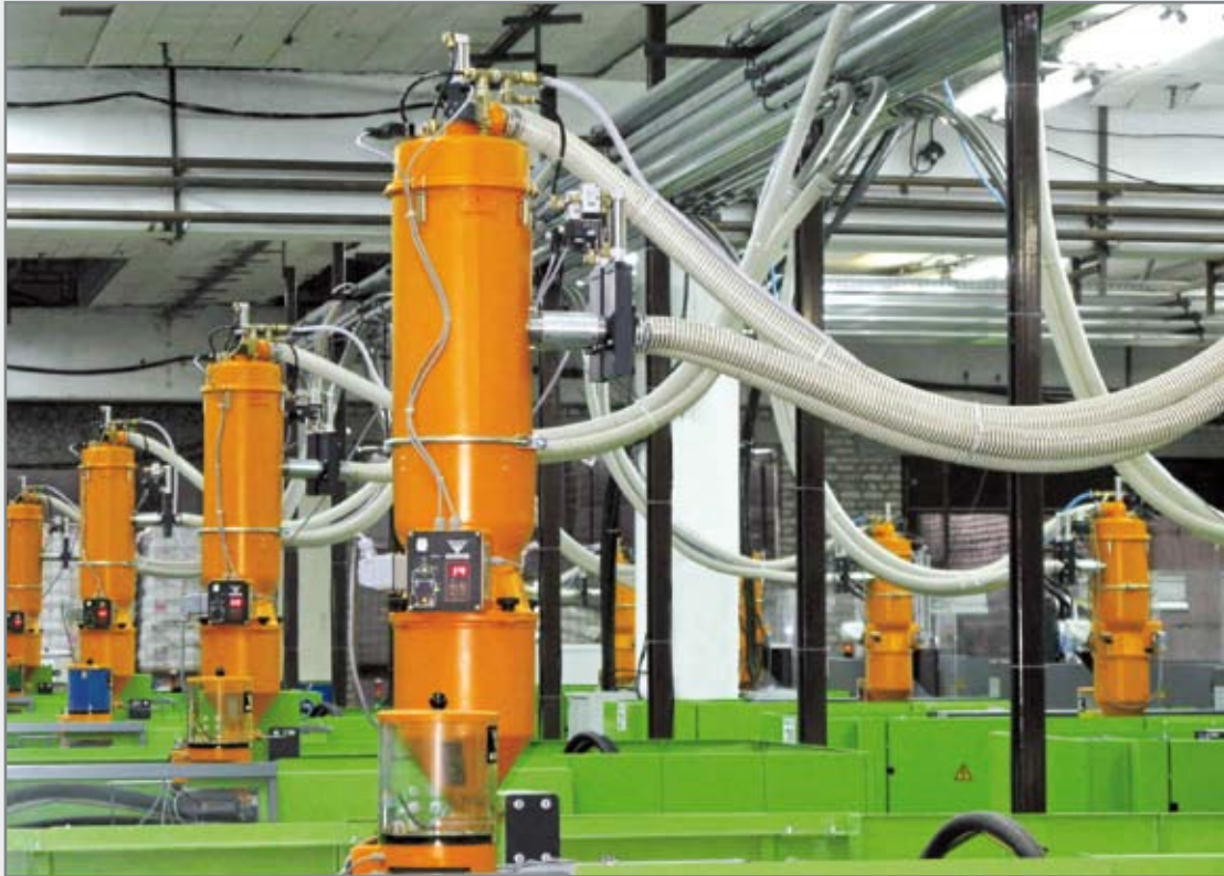
Zentralförderanlage mit Direkteinfärbung über KEM / AZ / Z12 + Tm A 30 Förderabscheider
